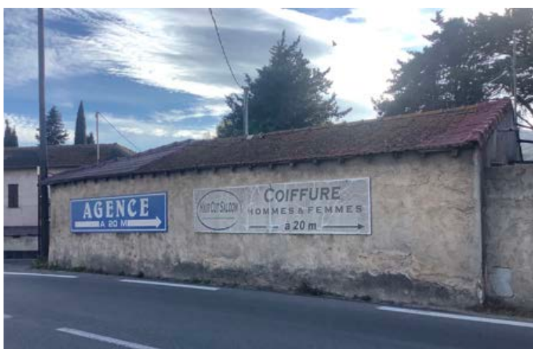
Préenseigne en mauvais état d'entretien, La Roquette-sur-Siagne, avril 2023
